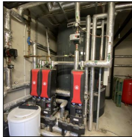
Photo de la chaufferie – Les Veyriers
